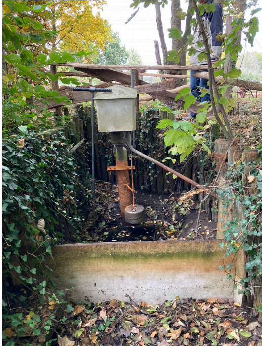
Foto 1. De stomp/pomp-combinatie (locatie D) voert overtollig water via een duiker onder de weg. Foto in oostelijke richting
